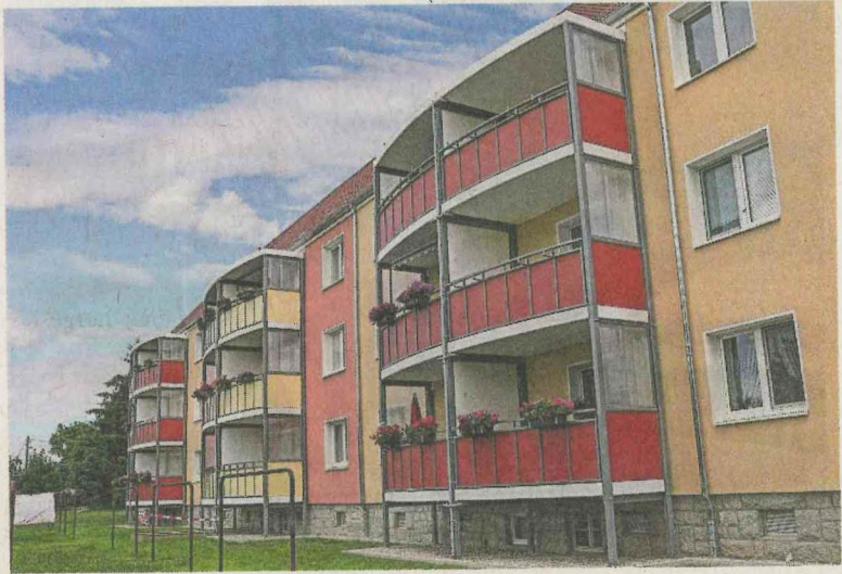
Erst vor wenigen Tagen beendet: Am Wohnblock Holzstraße 31 bis 33 a in Werdau-West sind Balkone angebaut worden.
