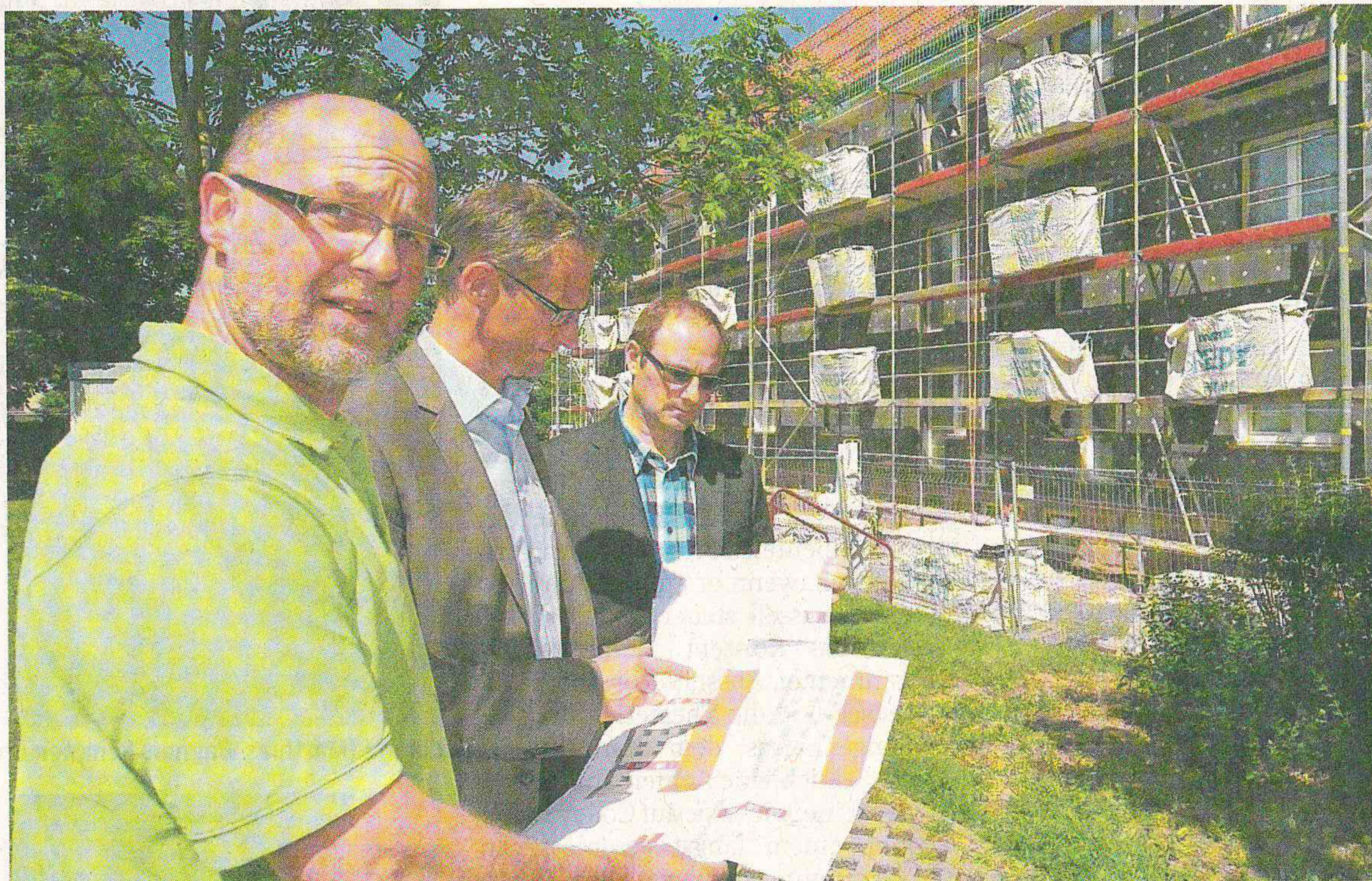
Der Anbau von Balkonen im Gartenweg 30/32 läuft planmäßig. Davon konnten sich Jörg Spiller vom betreuenden Ingenieurbüro, Vorstandsvorsitzender Norbert Gruss und Carsten Bendier vom Vorstand (v. l.) überzeugen. FOTO: T. MICHELI
